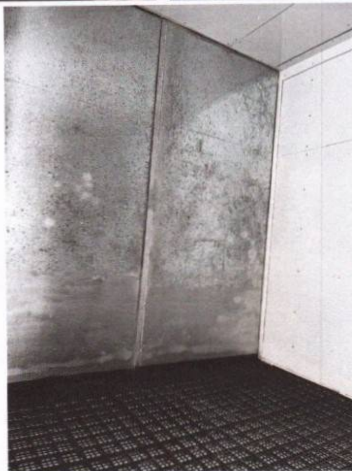
Imagens 03, 04 e 05- Vistas interna da câmara fria, encontrada desligada e sem produtos perecíveis.
